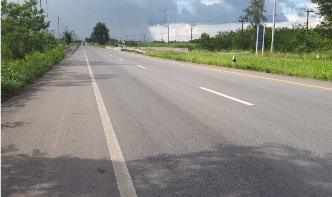
ภาพที่ 3.3 รูปภายหลังการบูรณะทางหลวงหมายเลข 344 ตอน อ.บ้านบึง – อ.แกลง กม. 37+ 800 RT
