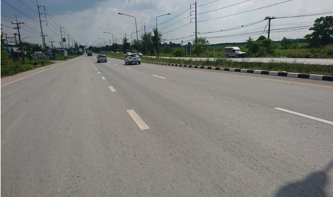
ภาพที่ 3.1 รูปภายหลังจากบูรณะทางหลวงหมายเลข 344 ตอน อ.บ้านบึง – อ.แกลง กม. 32+ 600 LT
